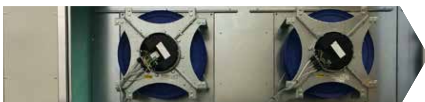
Ventilatori modulant e filtri ad alta efficienza
